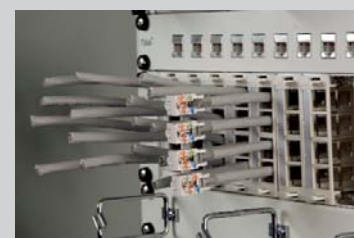
Câblage des guide-fils
