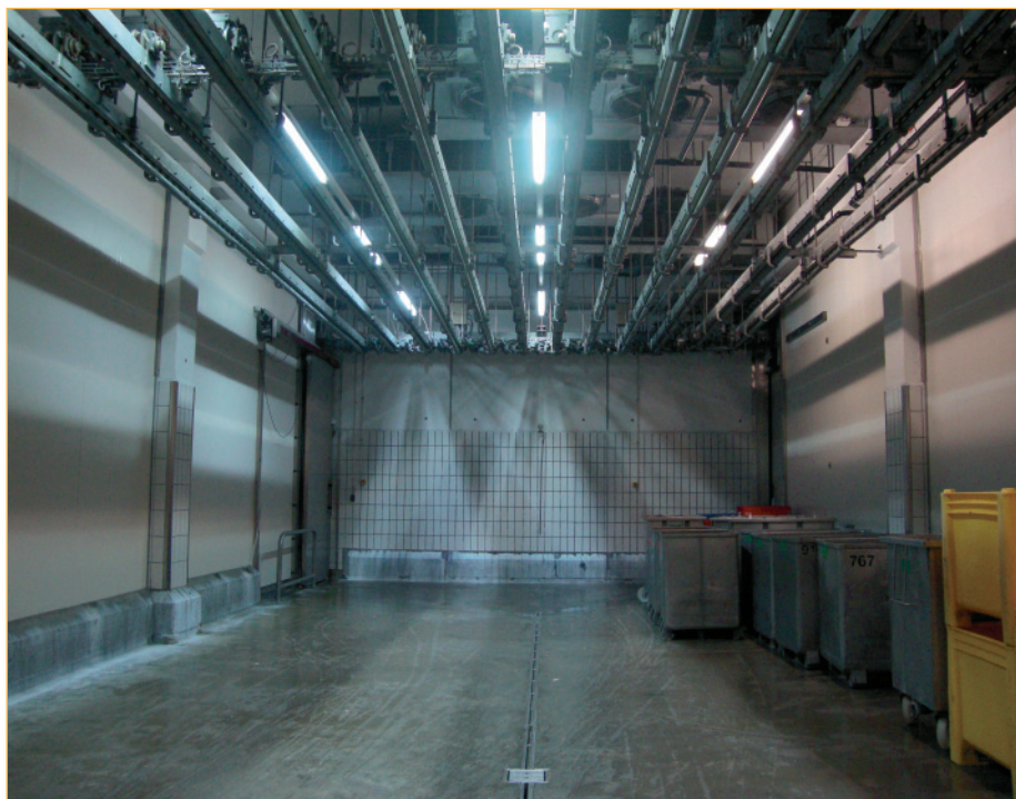
In den beiden linken Lichtsträngen in der rund 4,50 m hohen Kühllhalle sieht man die höhere Beleuchtungsstärke deutlich. Einen weiteren Vorteil erklärt Marco Egli: «Die herkömmlichen Leuchtstoffröhren brauchen bis zu einer Viertelstunde, bis sie voll leuchten – bei der LED-Röhre drücke ich den Schalter und das Licht ist 100% da.» (Bild: Marco Egli, ZSHAG)
