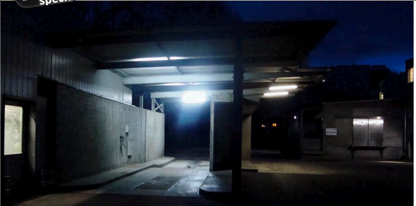
Die neu installierte LED-Röhre (links) am Aussenwaschplatz ist in ihrer Leuchtwirkung deutlich sichtbar
