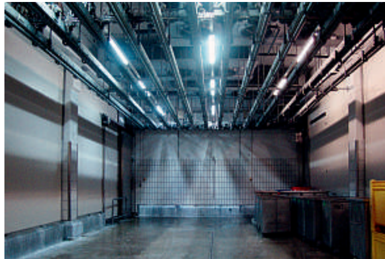
Die beiden linken Lichtstränge in der 4,5 m hohen Kühlhalle demonstrieren die höhere Beleuchtungsstärke der LED-Röhren deutlich.
